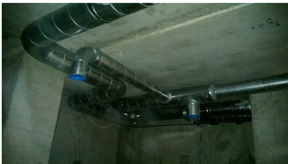
Kuva 6. Kuvan ilmanvaihtoasennuksissa on käytetty sivuliittimiä, näistä pitää tarkastaa tiiveys. Liitin pitää tiivistää liimalla tai teipillä. Asennetun kanaviston päät on suojattu.
