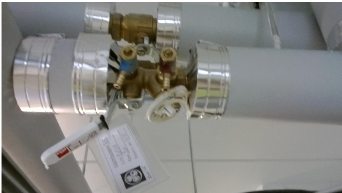
Kuva 2. Kuvassa on linjasäätöventtiili. Venttiilin kahvaan on kiinnitetty nippusitein lappu, jossa on linjasäätöventtiin säätöarvot.
