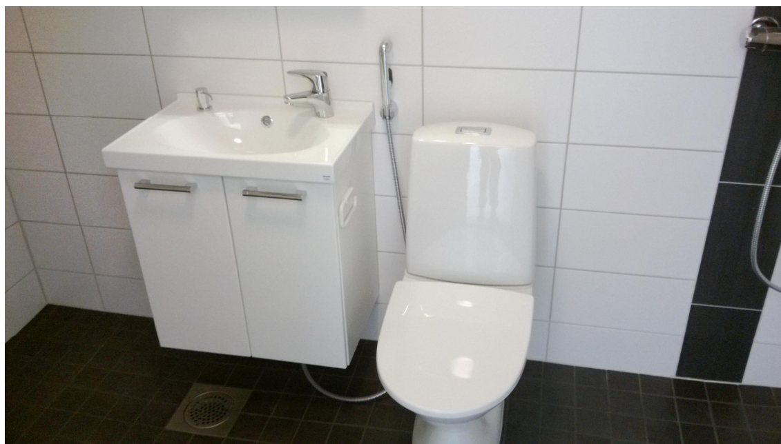
Kuva 4. Kylpyhuoneen pesuallas ja WC-istuin.
