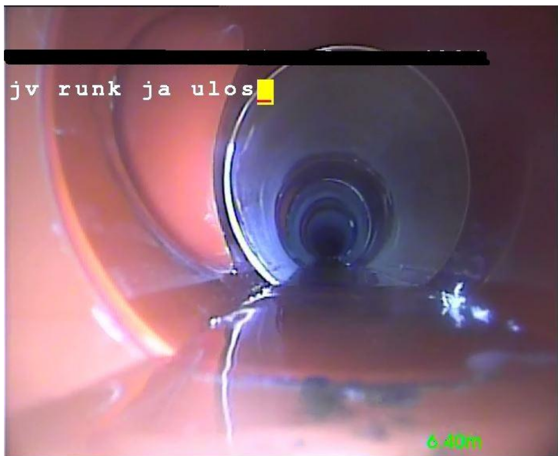
Kuva 5. Kuvakaappaus pohjaviemäriin videokuvauksesta.
