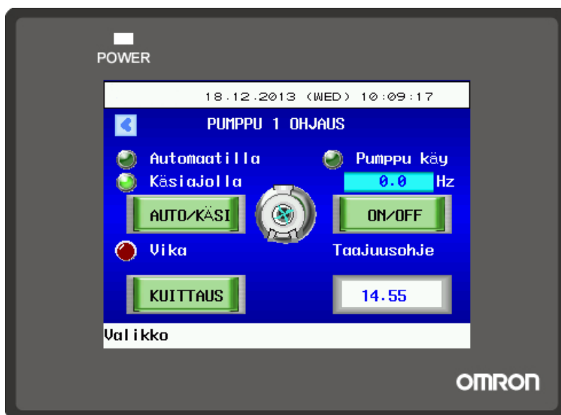
Kuva 12. Pumpun ohjaus sivu. (Kuva A.Haanpää 2013)
