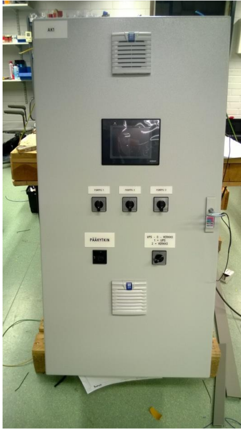
Kuva 2. Automaatiokeskus. (Kuva A.Haanpää 2014.)
