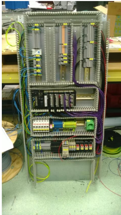
Kuva 7. Automaatiokeskuksen johdotus. (Kuva A.Haanpää 2013.)
