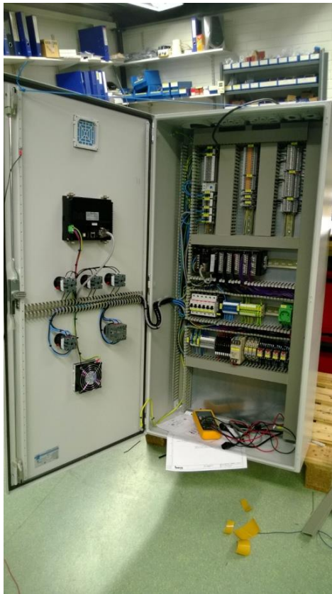
Kuva 8. Automaatiokeskuksen testaaminen. (Kuva A.Haanpää 2013)
