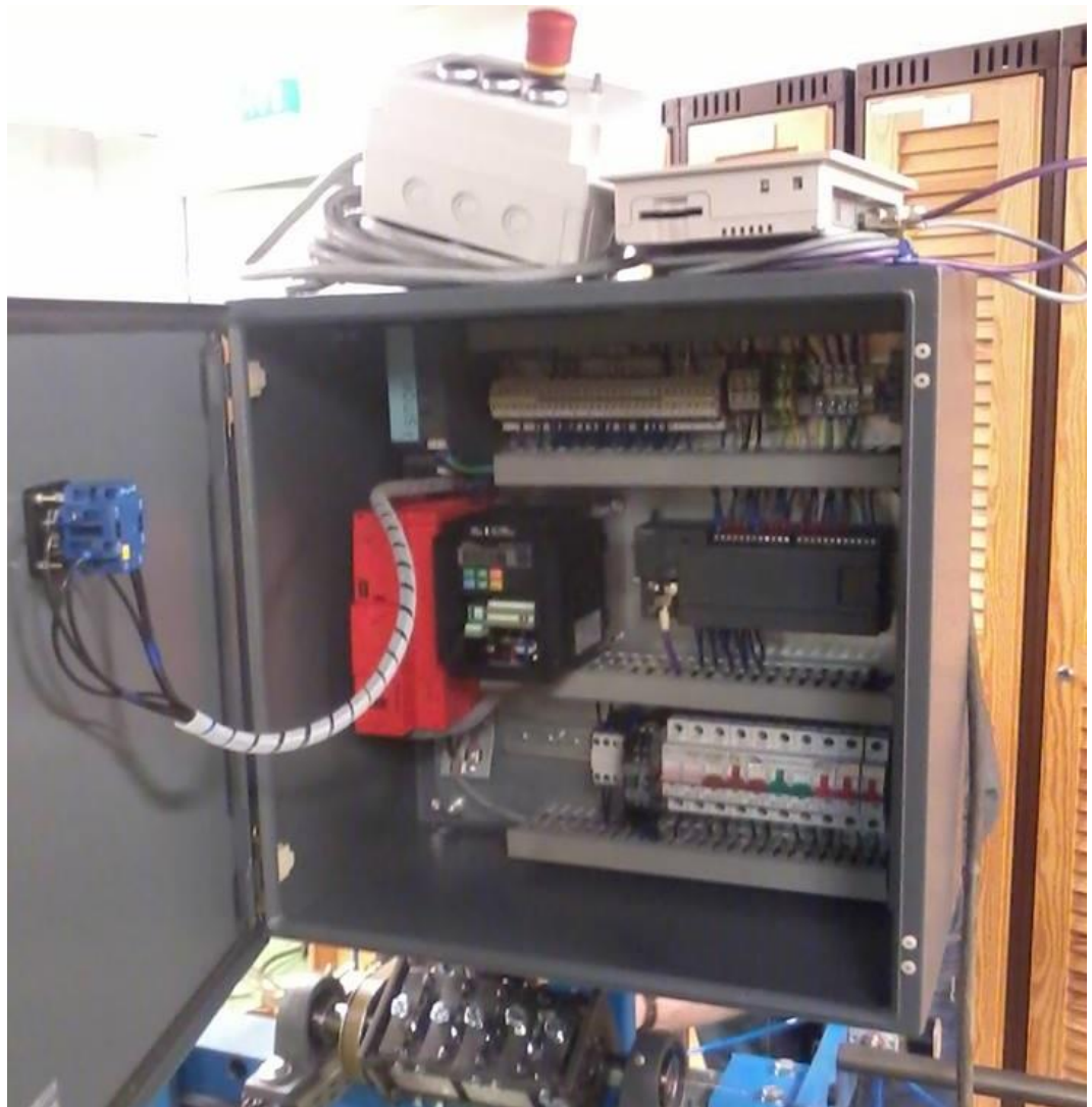
KUVA 6. Valmis keskus uudessa Rittalin teräskotelossa. Keskus on kiinnitetty laitteen runkoon kotelon takaosasta ja se sijaitsee suoristimen yläpuolella. Keskuksen päällä näkyy kosketuspaneeli ja moottorien ulkoinen ohjain
