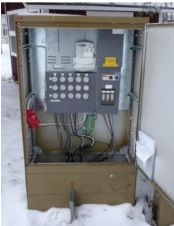
Kuva 1. Maahan asennettu katuvalokeskus
