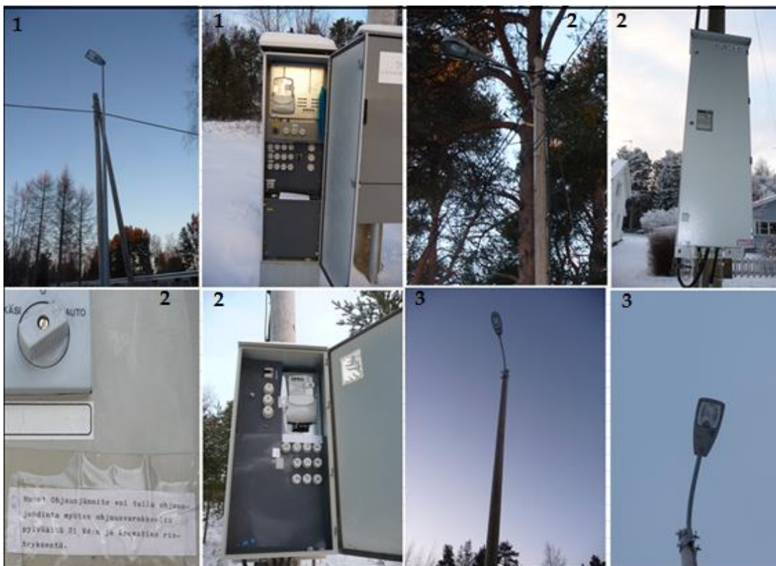
Kuva 20. Valokuvat Kauppilan alueen pylväistä, valaisimista ja keskuksista
