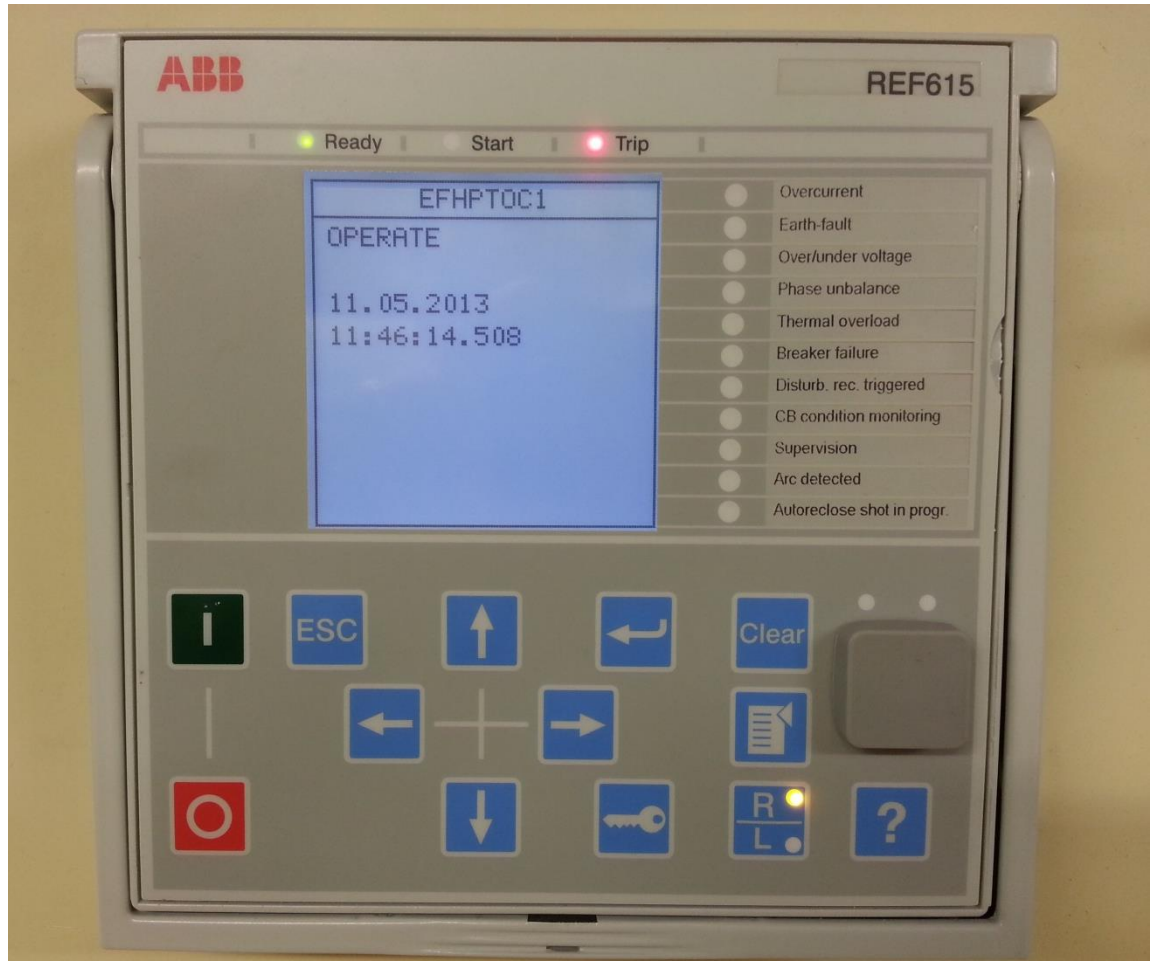
KUVIO 6. REF615 suojarеле Centria ammattikorkeakoulun sähkövoimatekniikan laboratoriossa.
