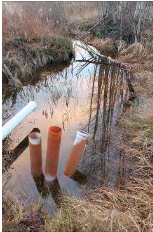
Kuva 7. Käsiniirrotettavien PVC-putkien ansiosta veden kulkusuunnan ja – nopeuden säätely on helppoa.
