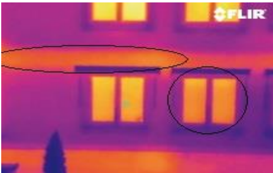
Kuva 18. Flir Tau -lämpökameralla otettu kuva kerrostalon seinästä (Thermografien www-sivut 2013)
