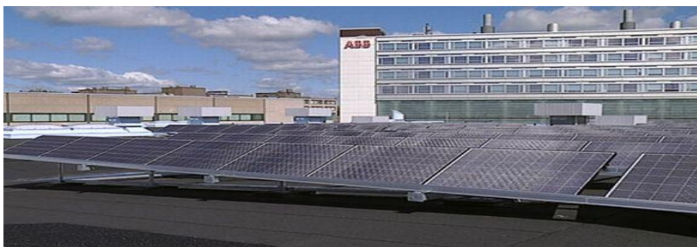
KUVA 1. Helsingissä käynnistyi Pohjoismaiden suurin aurinkosähkövoimala (Yle 2010)
