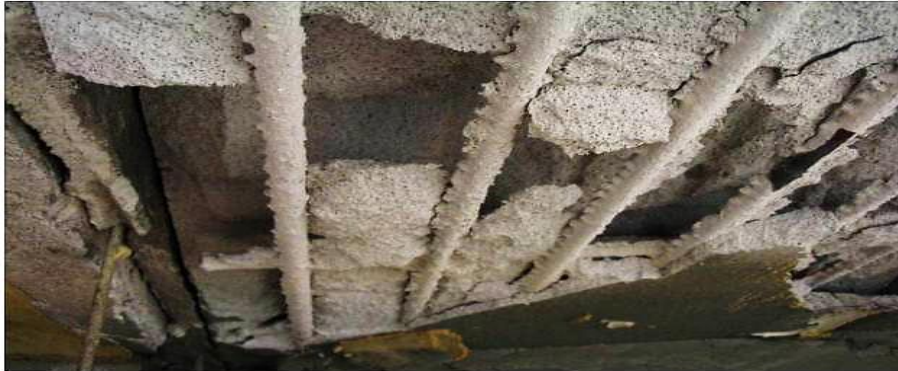
Kuva 10. Pahasti pakkasrapautunut yläpohjalaatta [23, s. 7].
