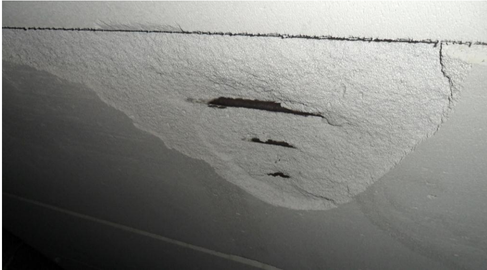
Kuva 20. Lohkeamat suurimmillaan alapohjalankuissa.
