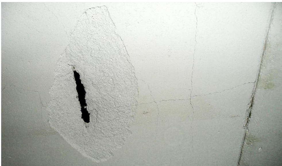
Kuva 21. Lohkeama ja sen vieressä olevat halkeamat.
