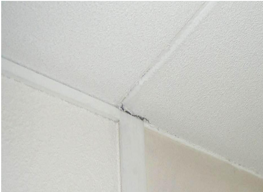
Kuva 13. Höyrykarkaistun kevytbetonin tyypillistä halkeilua [13].
