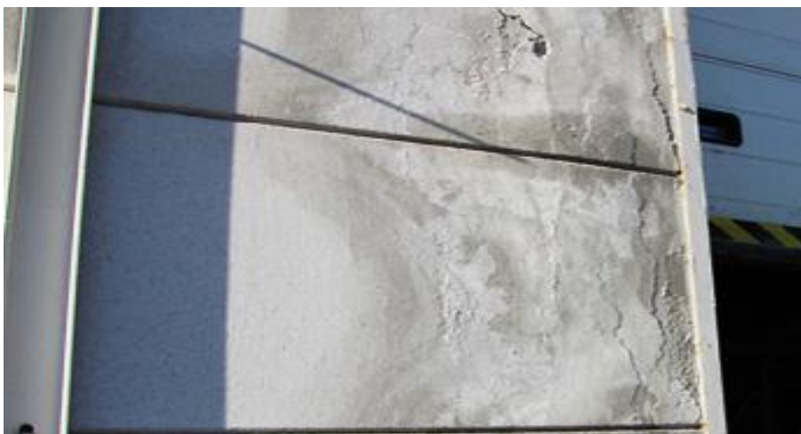
Kuva 11. Karkaistun kevytbetonin jäätymis-sulamissykliin aiheuttamaa rapautumista [13].
