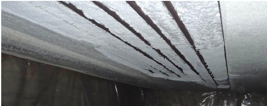
Kuva 8. Alapohjalaatan alapinnan terästen pitkälle edennyt vaurioituminen [13].
