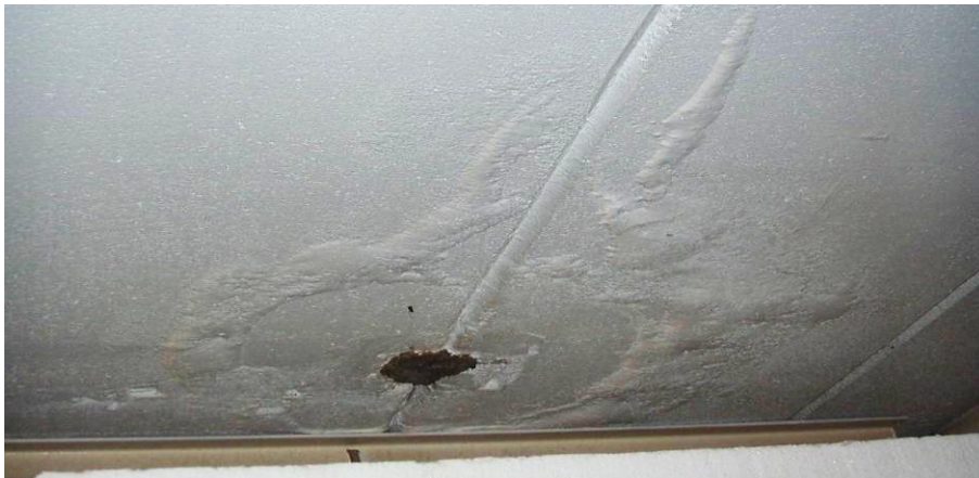
Kuva 15. Kosteuden aiheuttamaa pullistumista maalipinnassa [13].
