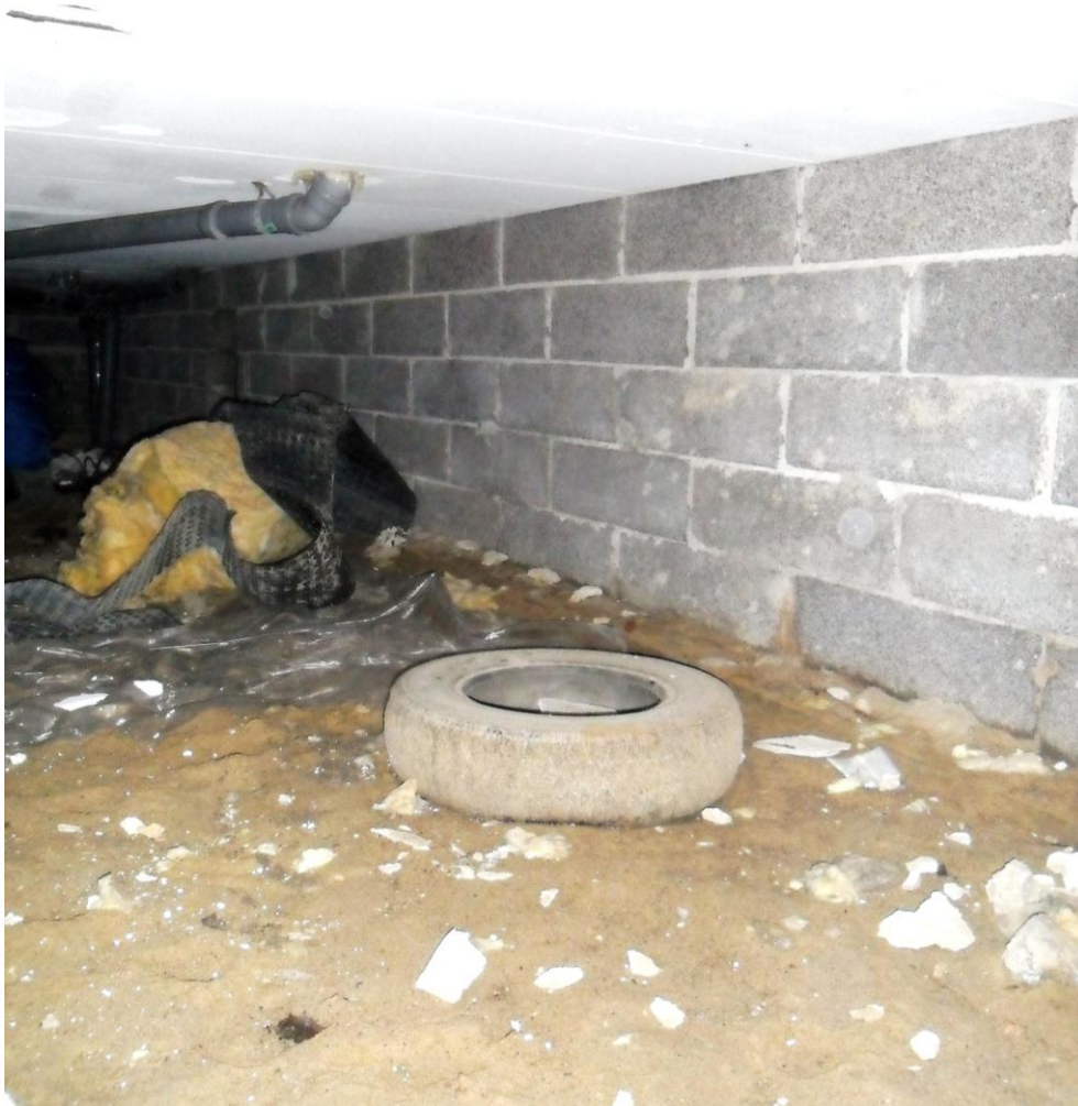
Kuva 19. Ryömintätilassa havaittavia jätteitä.
