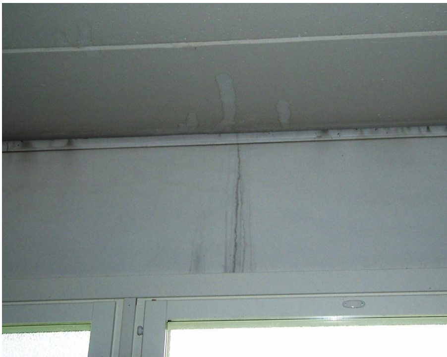
Kuva 12. Suolanmuodostumista karkaistun kevytbetoniyläpohjan alapinnassa [13].
