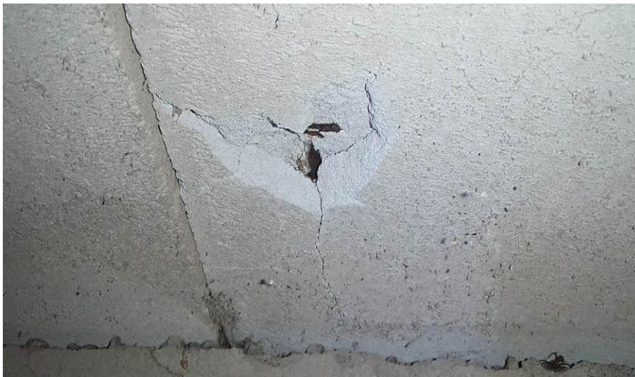
Kuva 7. Teräskorroosion aiheuttama alapohjalaatan alapinnan lohkeaminen [13].
