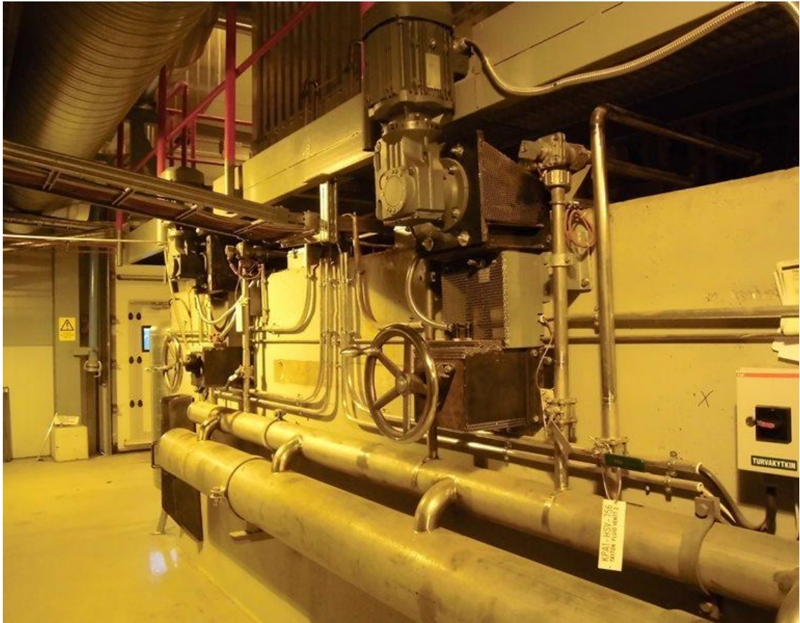
Kuva 7. Pudotusputken turvapellit laitteistoinen (Kemin Energian lämpökeskus)
