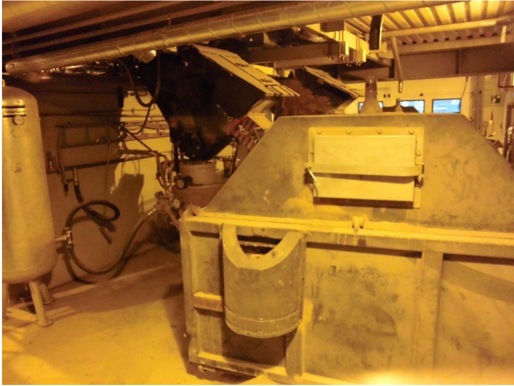
Kuva 11. Hiekkalava (Kemin Energian lämpökeskus)
