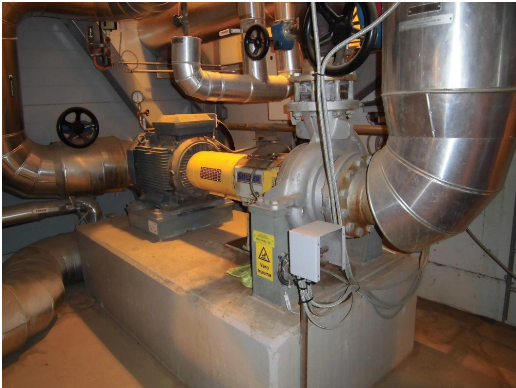
Kuva 13. Kattilapiirin pumppu (Kemin Energian lämpökeskus)
