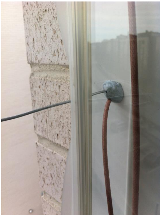
Kuva 28. Suhteellista kosteutta ja lämpötilaa mittaava anturi asennettuna.
