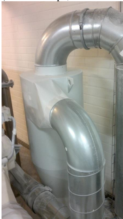
Kuva 10. Kuvassa Turengin tehtaan erotussykloni.
