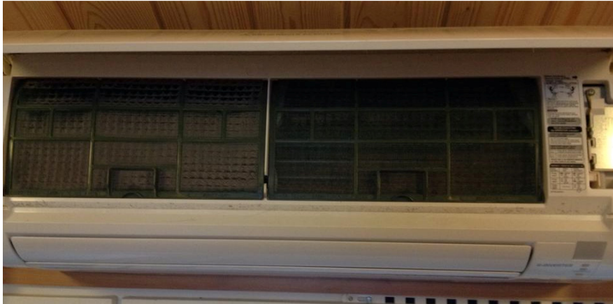
Kuva 17. Likainen ja puhdistettu suodatin
