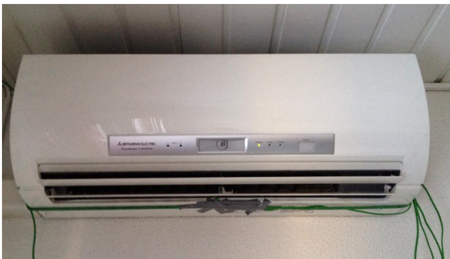
Kuva 22. Ilmalämpöpumppu ja lämpötila-anturit
