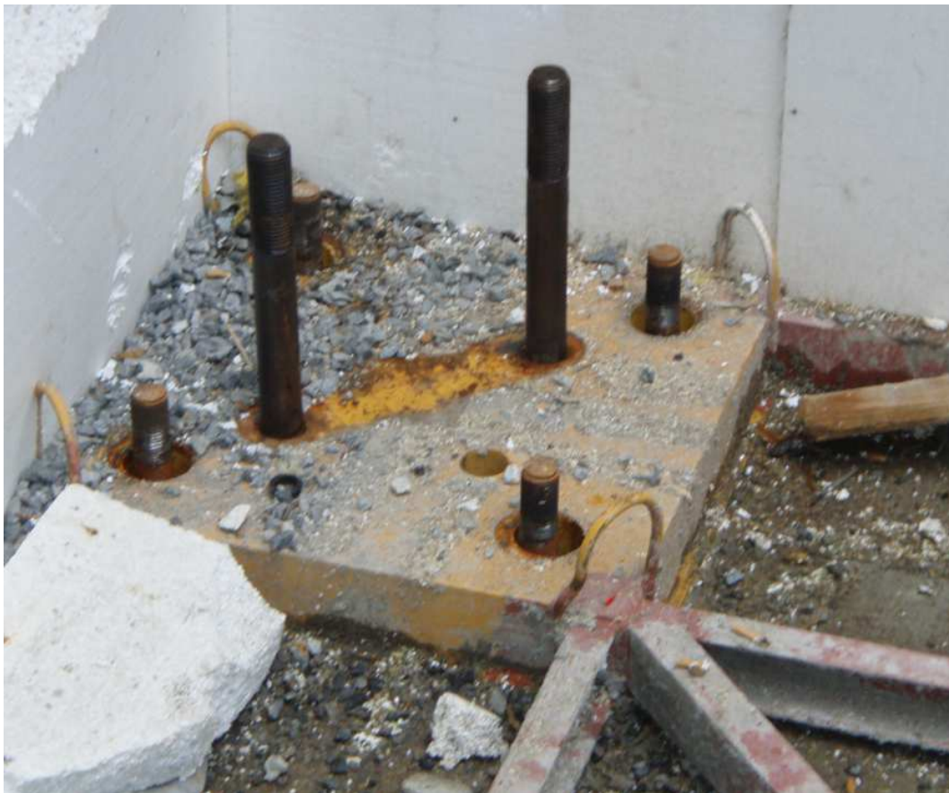
Kuva 6. Torninosturin pulttikiinnitys perustukseen [kuva, Jan Wallenius].
