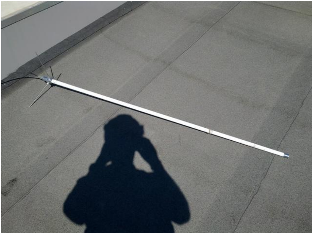
Kuva 13. Tukiasemanantennin huolimaton asennus. [17.]
