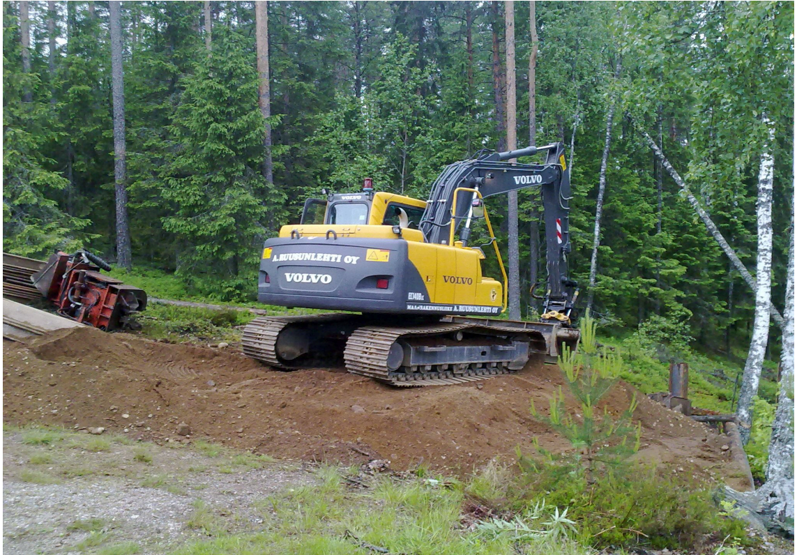
Kuva 9. Mökkien pontitustyömaa Nummi-Pusulassa hiekkaisella maaperällä. Lyhyitä pontteja (2-5 m) lyötäessä maaperän hiekkaisuus ja kitka eivät ole merkittävään häiritseviä tekijöitä, koska ponttiin kohdistuva kitka vaikuttaa vain lyhyellä matkalla
