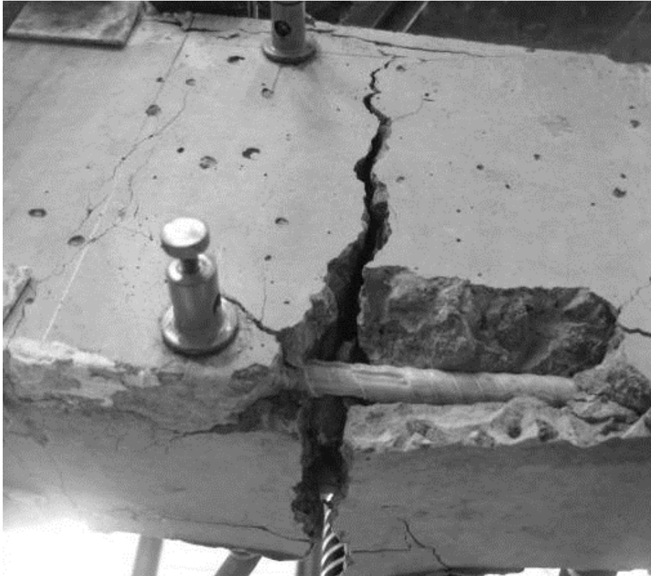
Kuva 7. Kuvan betonipalkissa on tapahtunut haurasmurtuma. (14.)
