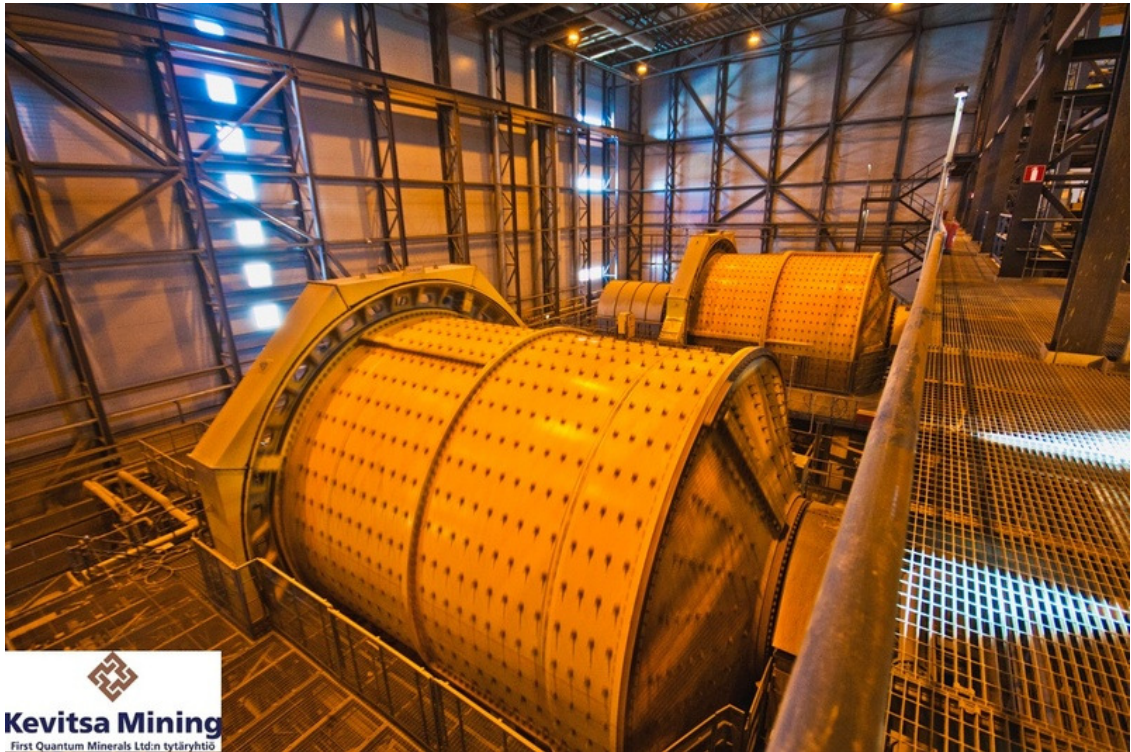
Kuva 3. Kevitsan jauhimon primäärimylly 2 ja sekundäärimylly (Kaivos www-sivut 2013, hakupäivä 18.11.2013)
