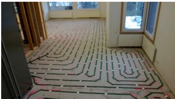
Kuvio 32. Vanhaan betonilattiaan uritettu lattialämmitys (Lattialämmitysjärjestelmät, [viitattu 15.3.2014]).
