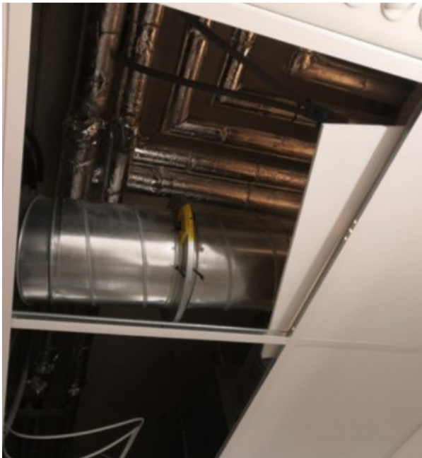
KUVA 15 Säätopelti (IRIS-250) asennettuna IV-kanavaan
