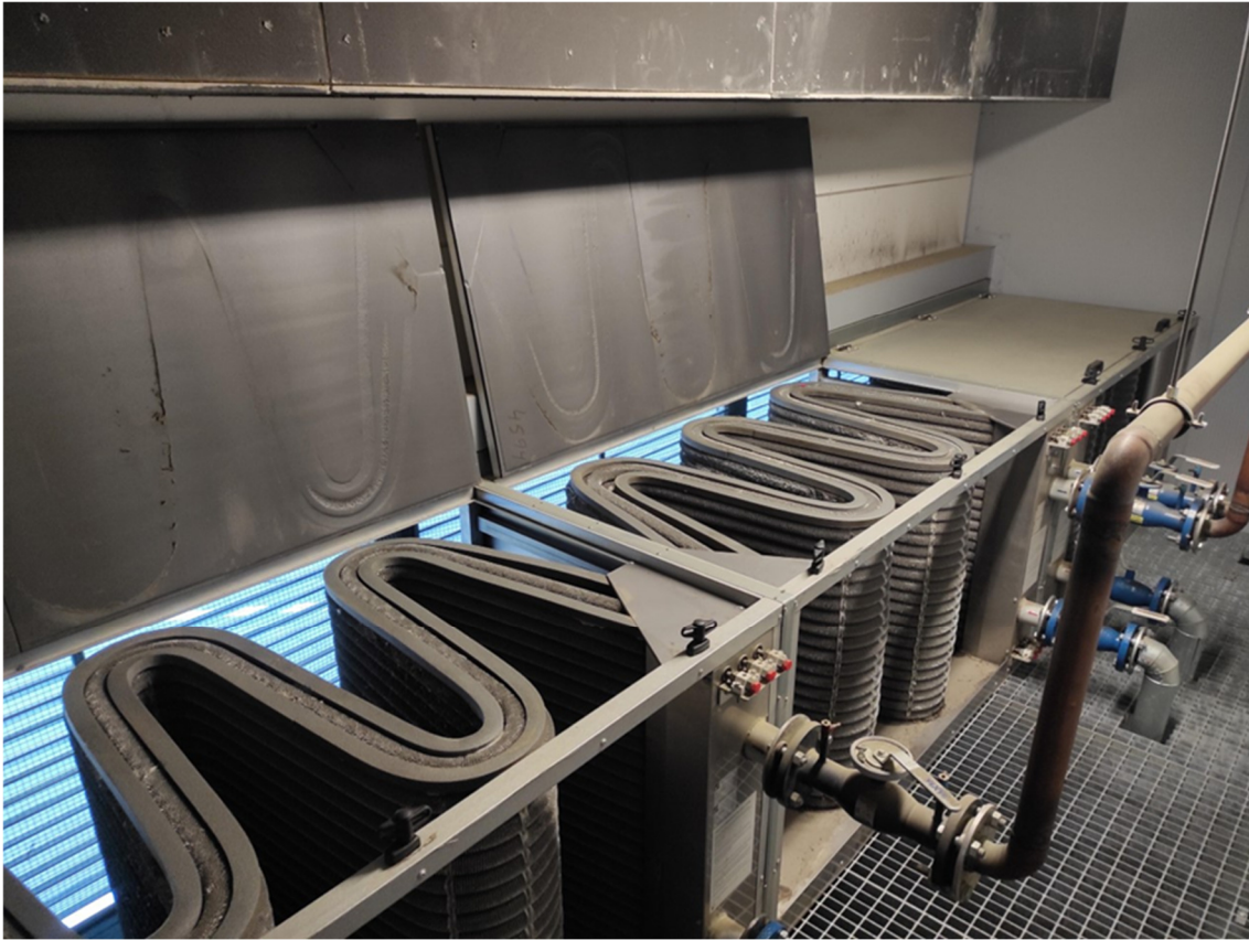
KUVA 9 Lämmöntalteenoton (Retermia) neulapatterit 3kpl sijaitsevat raitisilmakammiossa.
