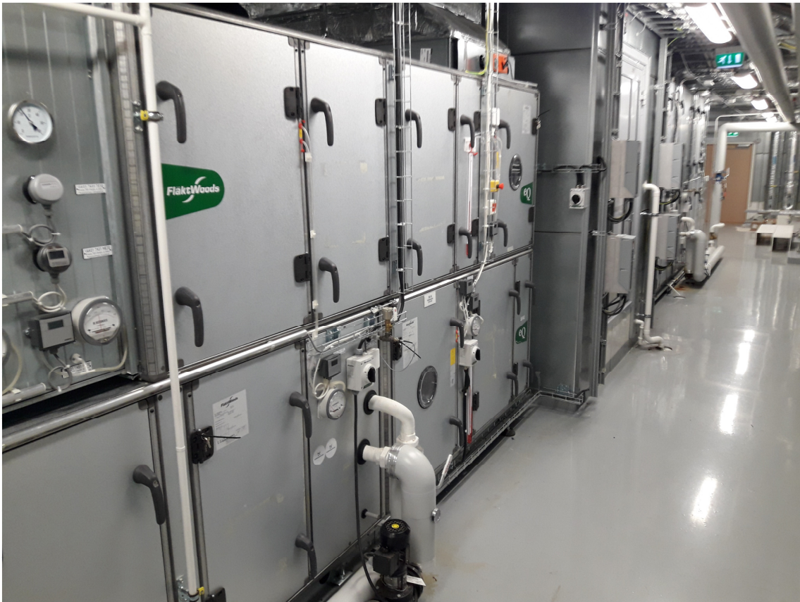
KUVA 11 IV-koneiden TK01:n ja TK03:n välissä on ovi raitisilmakammioon
