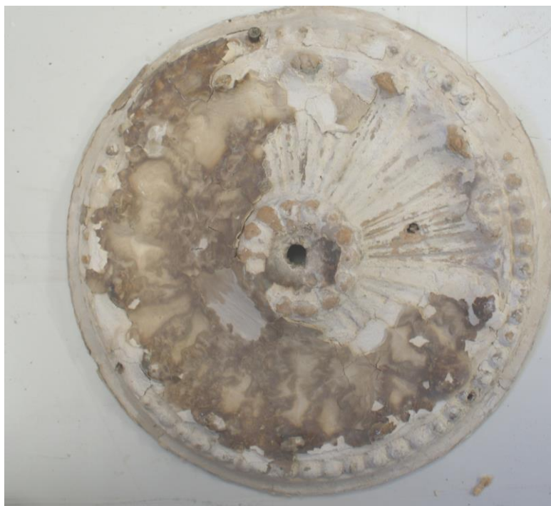
Kuva 58. Kosteusvaurioita rosetin pintakäsittelyssä.
