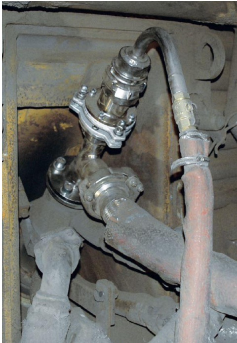
Kuva 18 RCB Temp asennettuna (Siemens VAI 2011. Hakupäivä 25.3.2014).
