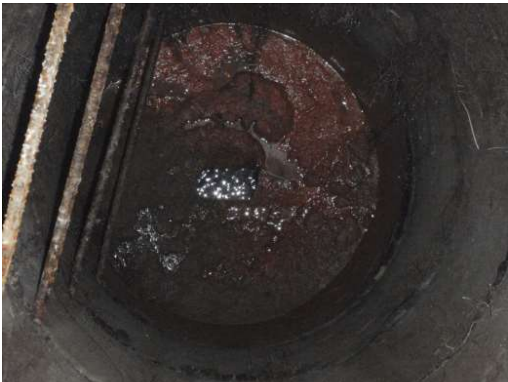
Kuva 1 Kaivo 5.03 vuotaa (Antti Väänänen 2.7.2013)
