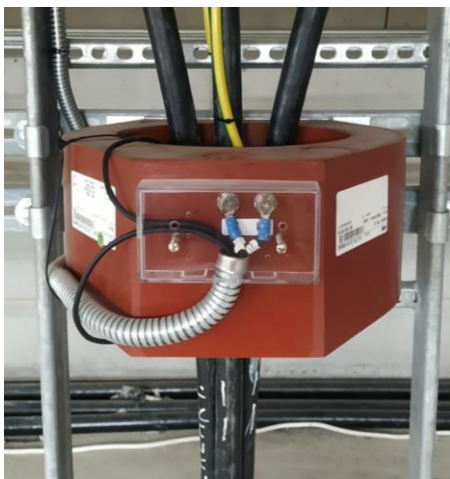
Kuva 5. 20 kV lähtökennon kaapelivirtamuuntaja. 2021.
