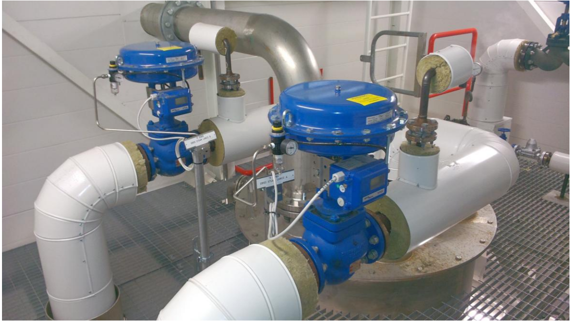
Kuva 10, höyryventtiilit TV6186A ja TV6186B
