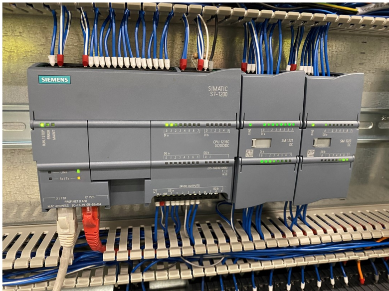
Kuva 8. Logiikka asennettuna ohjauspulpettiin
