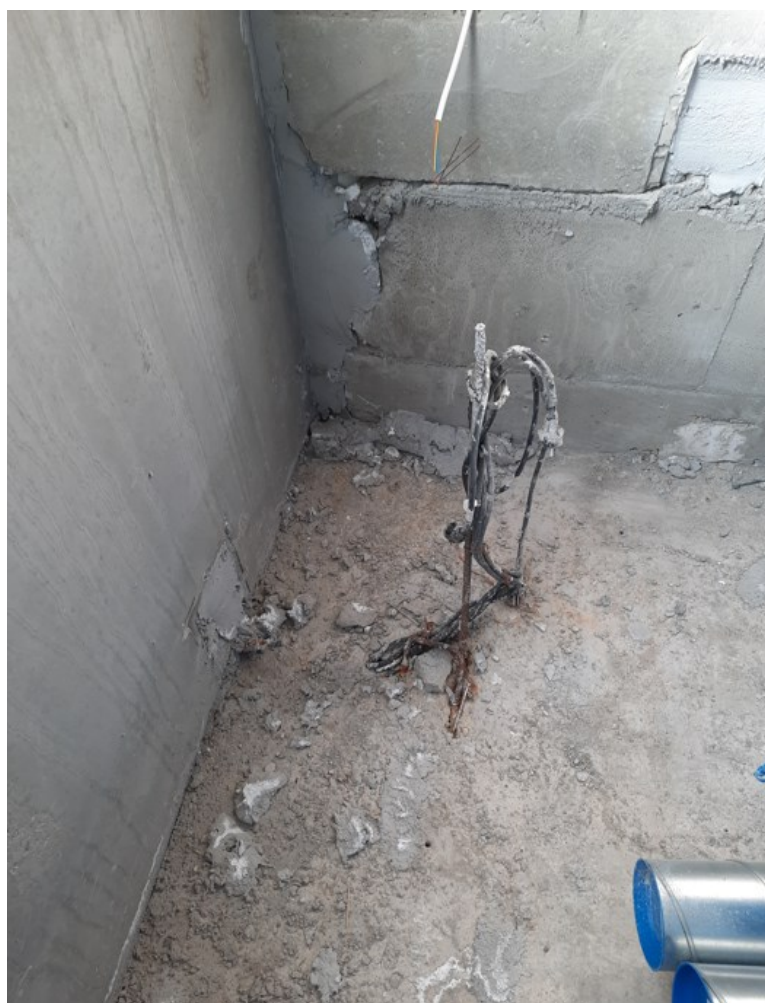
KUVA 7. Lämmityskaapelien pistotulpat (Kouhia 2022)
