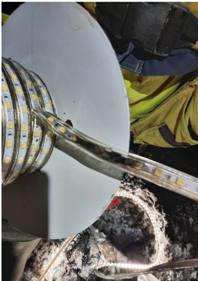
KUVA 20. Vioittunut LED nauha (Kouhia 2022)
