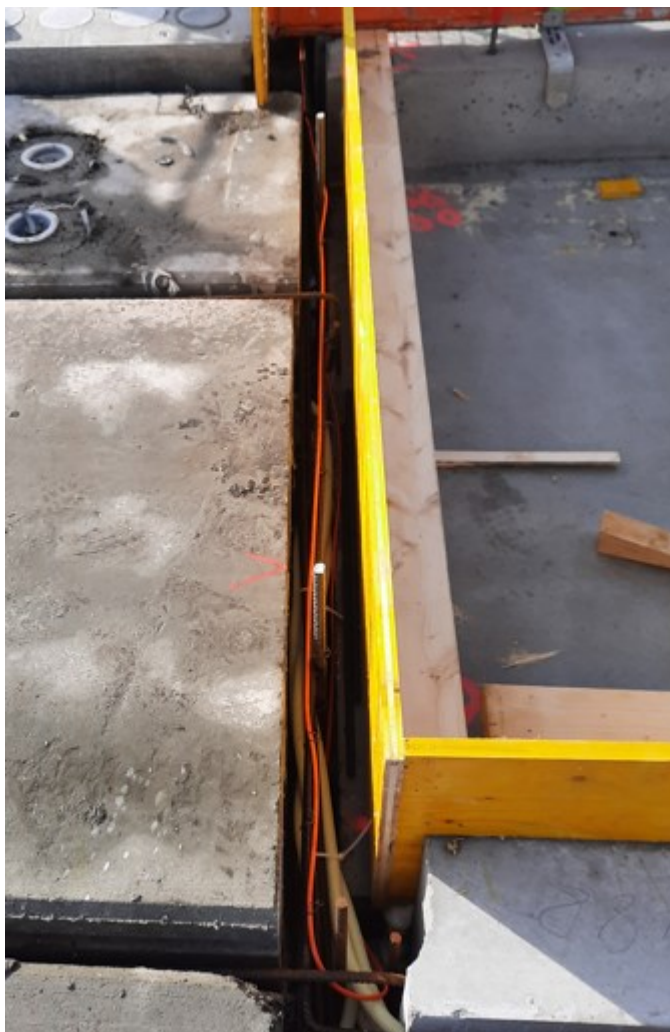
KUVA 8. Valukaistassa lämmityskaapeli (Kouhia 2022)
