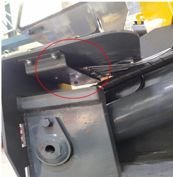
Kuva 15. Annostinryhmä (kuvassa ympyröityinä) suojattuna porras askelman alla. (Kivinen 2021).
