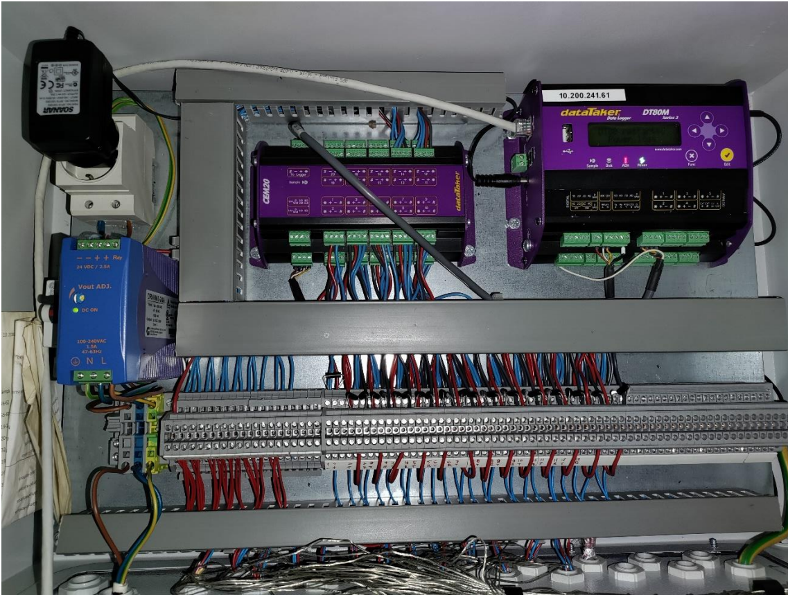
Kuva 4. Maalaamossa 1 käytössä olevan Dataloggerin kytkentä
