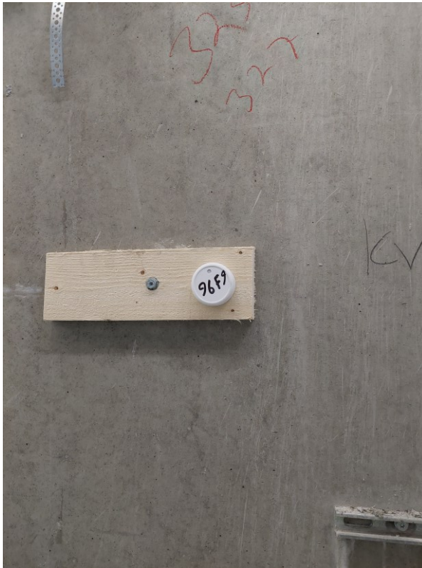
Kuva 7. RuuviTag mitta-anturi asennettuna työmaalla käytävän seinään. [8.]
