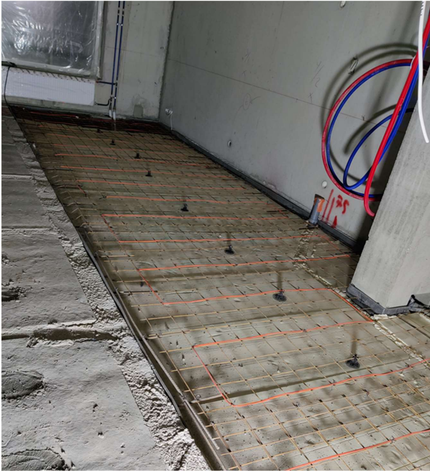
Kuva 9. Lattiavaluun asennetut lämmityskaapelit
