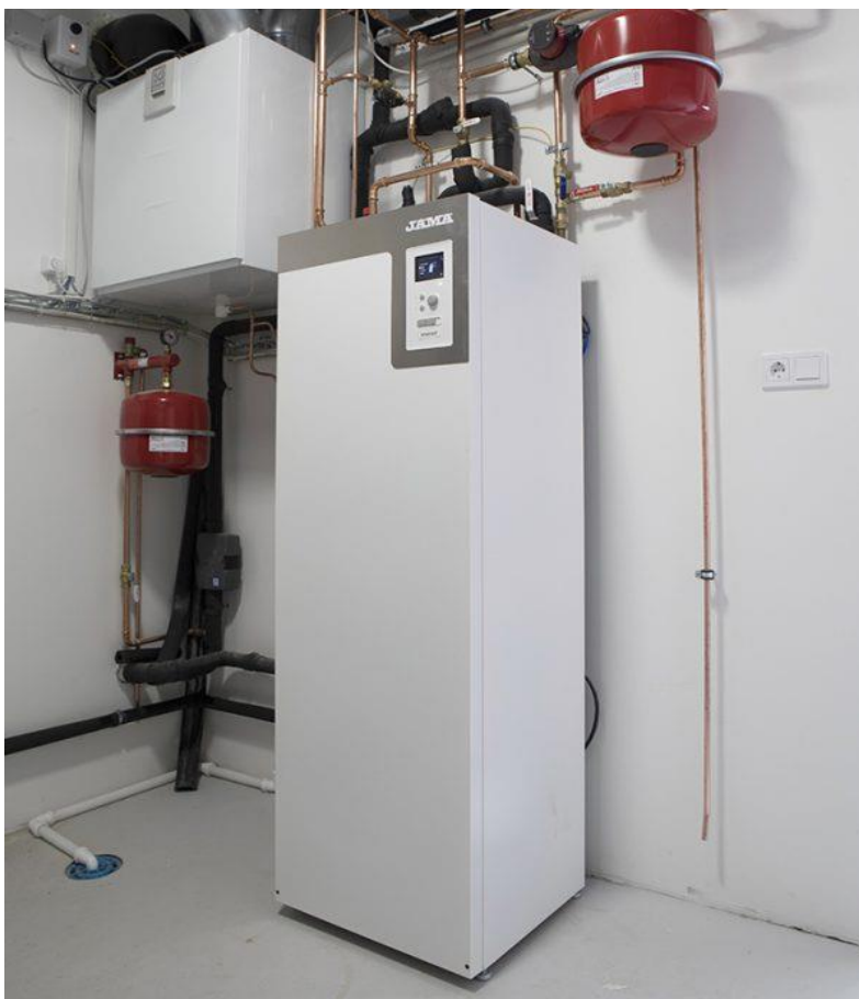
Kuva 6. Maalämpöpumppu asennettuna pientalokohteeseen. (12.)
