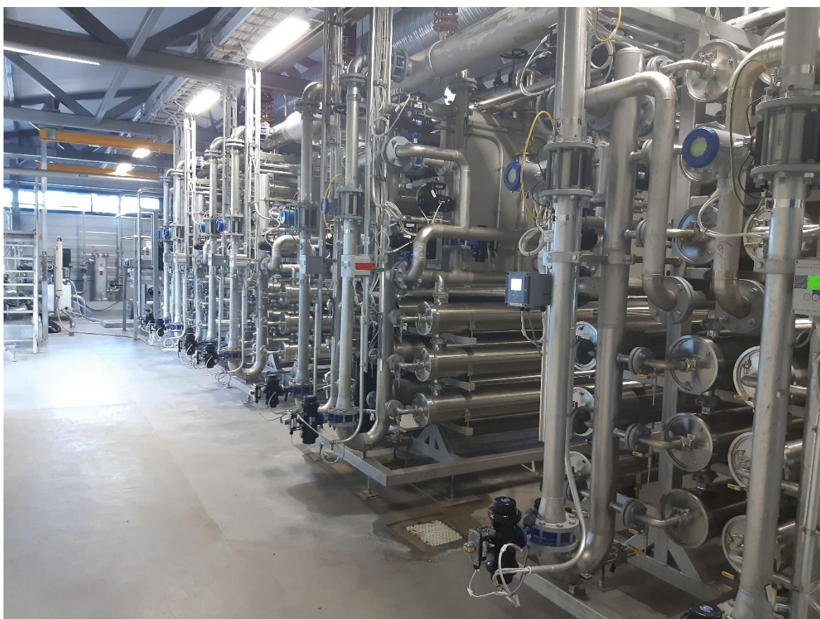
Kuva 4. Fluoridinpoistolaitoksen membraanisudatin koneikkoja, joissa tekopohjavettä suodatetaan.
