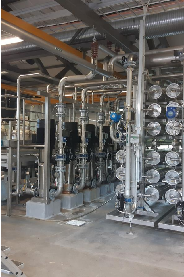
Kuva 17. Prosessitilan paineenkorotus pumpput ja niistä lähtevät putket membraanikalvo-suodatinkoneikoille.
