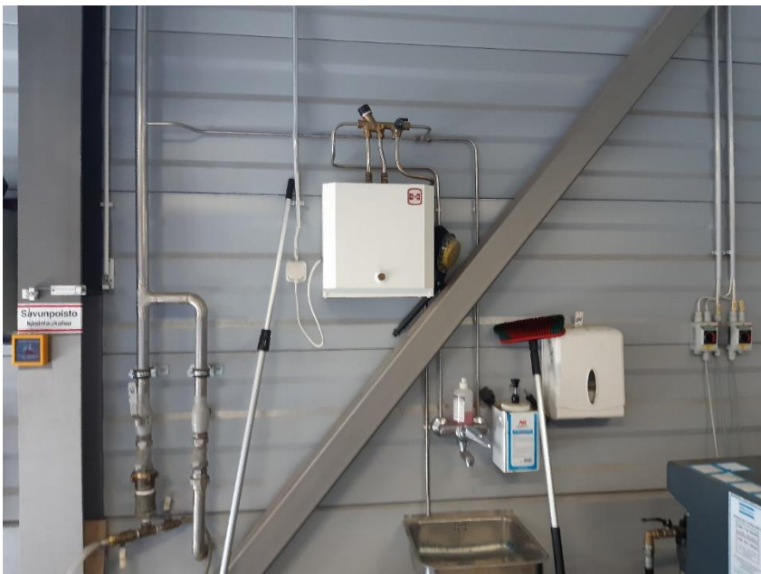
Kuva 16. Varaston pieni lämminvesivaraaja, joka olisi mahdollisuus muuttaa maalämpökäyttöiseen lämminvesivaraajaan.
