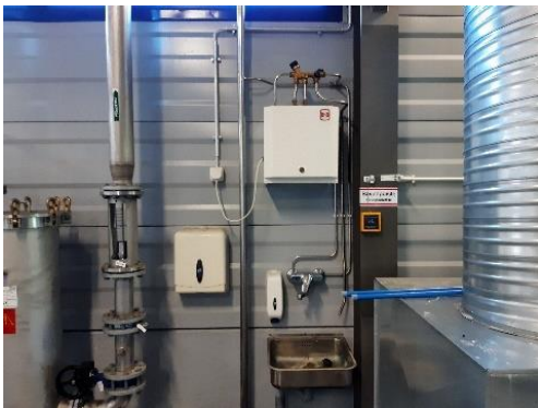
Kuvat 22. Pienlämmivesivaraaja, joka on sijoitettuna käyttöpisteen yläpuolella ilmanvaihtokoneen viereen.
