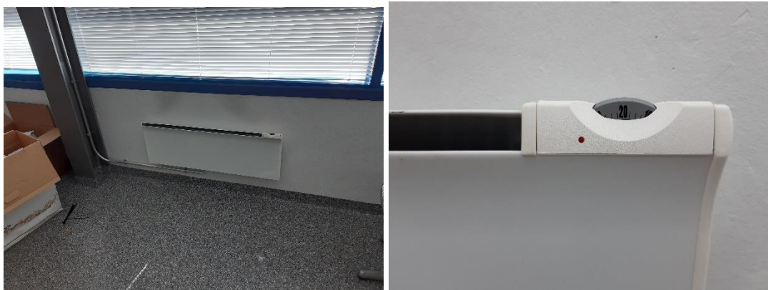
Kuva 12 ja 13. Patterit valvomossa.
