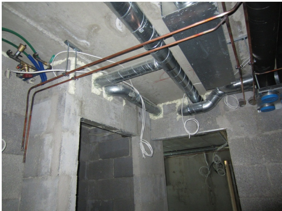
Kuvio 4. Kylpyhuoneen paikalla rakennettua talotekniikkaa
