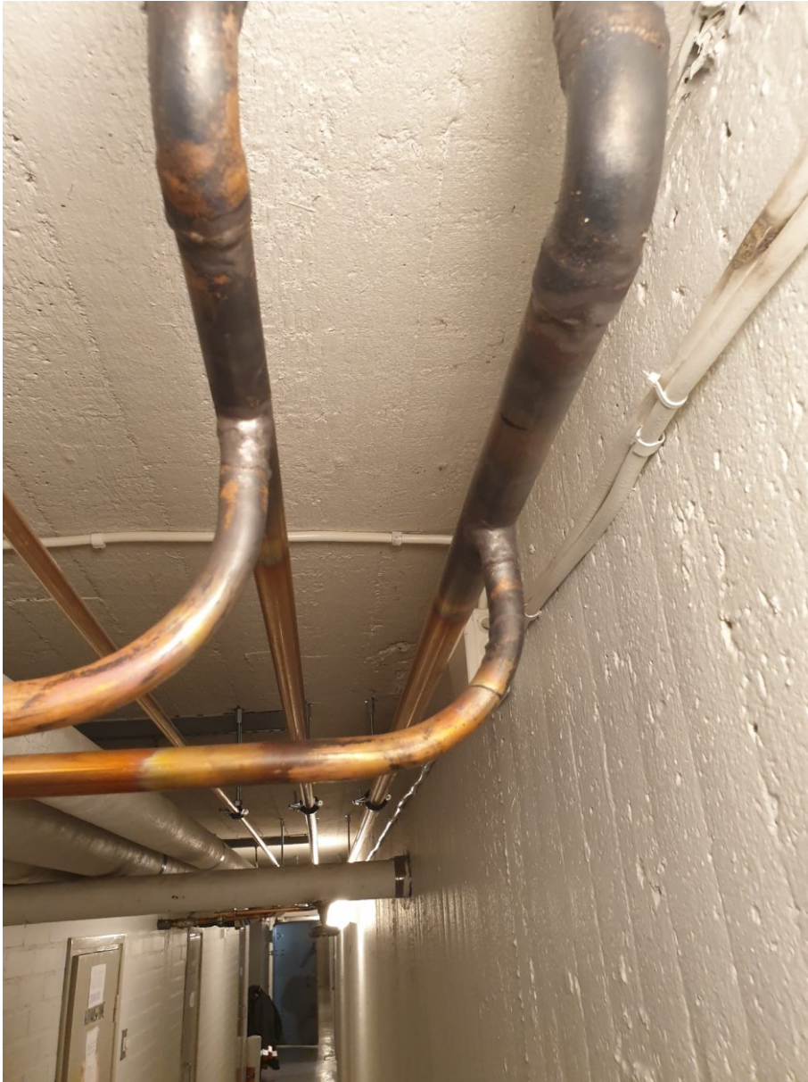
KUVA 4. Kylmän ja lämpimän veden runko kellarissa, josta haarat pesutupaan
