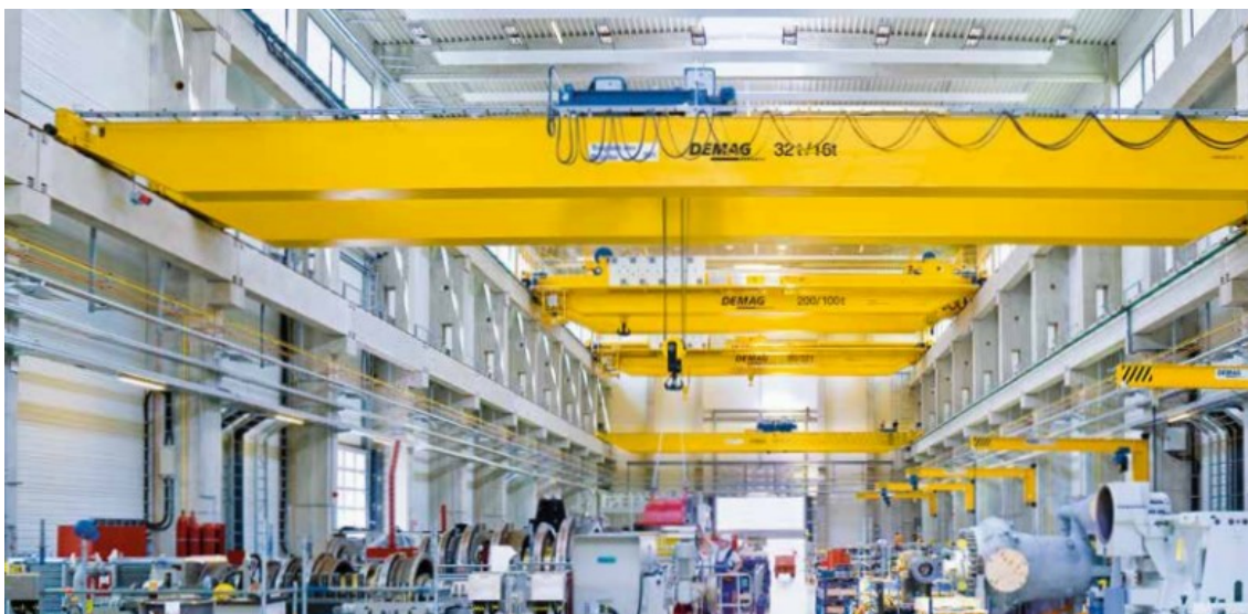
KUVA 5. Demag siltanostureita tuotannossa (Crane systems to meet your application needs)
