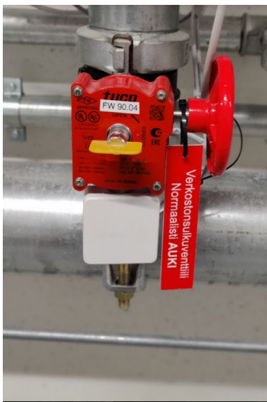
Kuva 12 Valvottu verkoston sulkuventtiili
