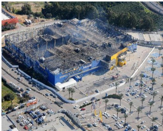
Kuva 1 Ikean myymälävarastorakennuksen palo 2011 Israelissa (Jan Lagerblad esitysmateriaali High storage protection seminar 2012)
