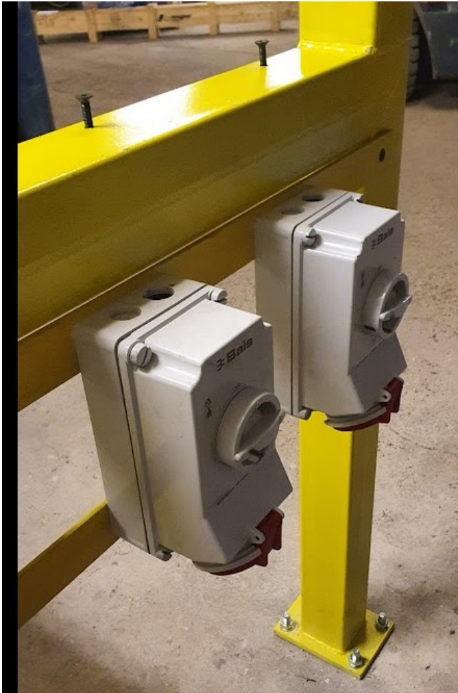
Kuva 17. Latureiden pistorasiat kaiteeseen asennettuna.
