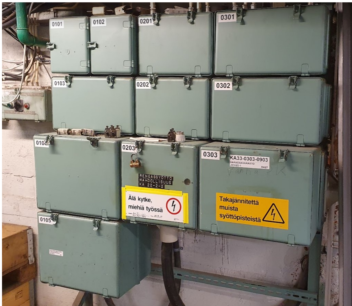
Kuva 11. Sähkökeskus JK102D-1 (KA33-0303-0903).
