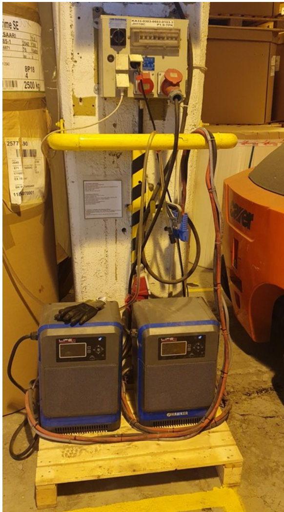
Kuva 10. Varastotilaan rakennettu tilapäinen latauspaikka.
