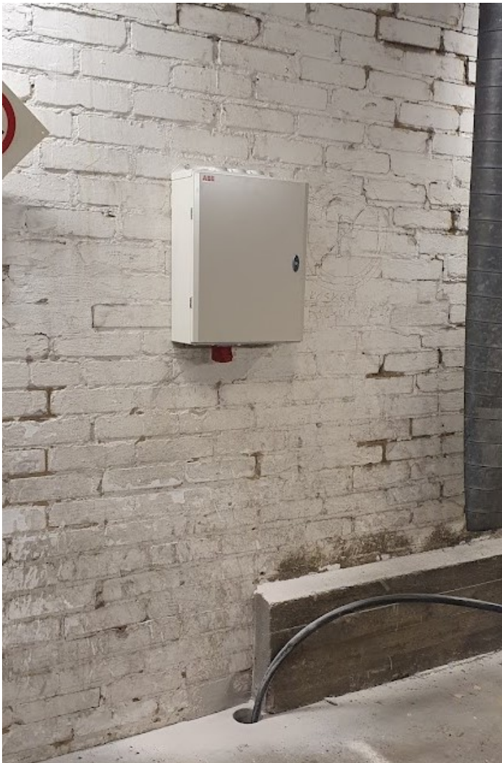
Kuva 16. Trukkitallin latauskeskus ja syöttökaapeli.
