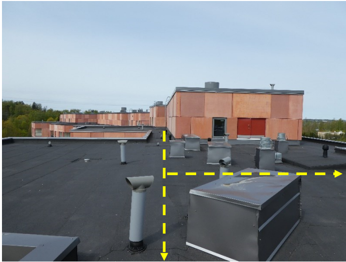
Kuva 10. Kaapelireitti katolla antenneille ja laitepedille.
