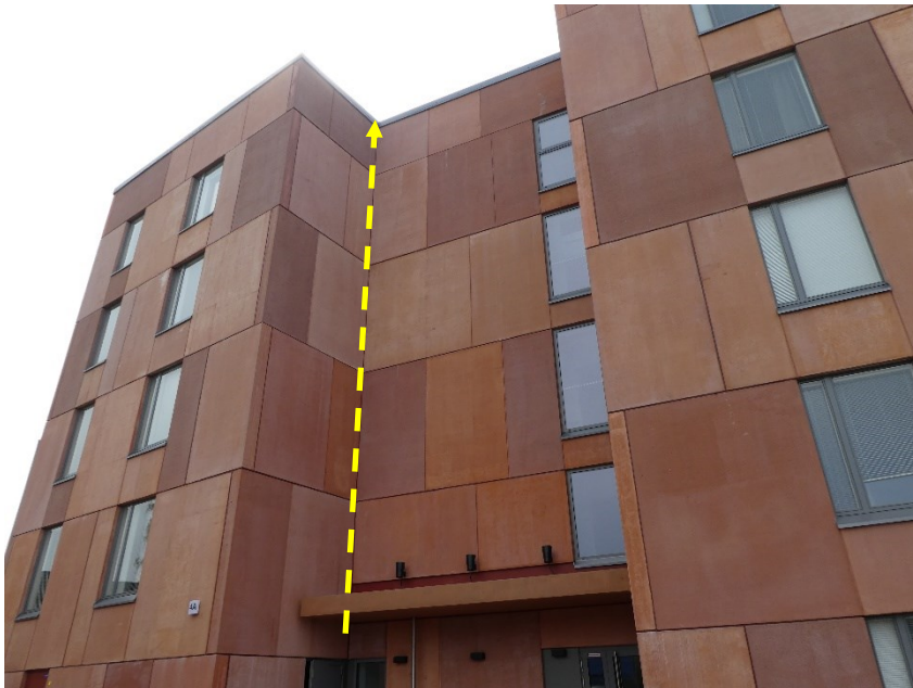
Kuva 9. Kaapelireitti kiinteistön seinää pitkin ylös katolle.
