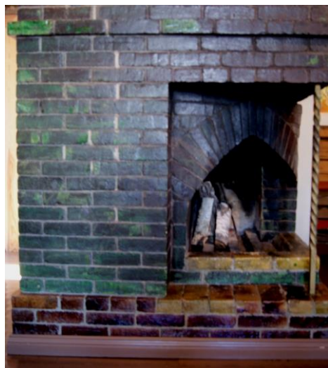
KUVA 55. Takan etuosan kulunutta maalipintaa (Jauho 2013)
