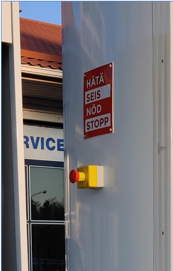
Kuva 36. Hätäseis-painike mittarikatoksen tolpassa.
