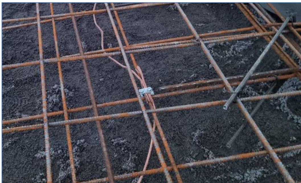
Kuva 27. Täyttöpaikan betoniraudoituksen maadoituskupari.
