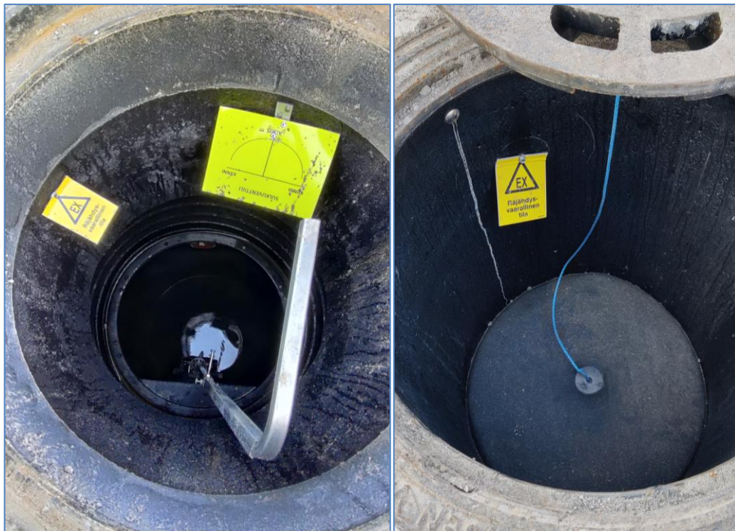
Kuva 35. Sulkuventtiilikaivon merkinnät vasemmassa kuvassa, oikealla hiekanerotuskaivo.
