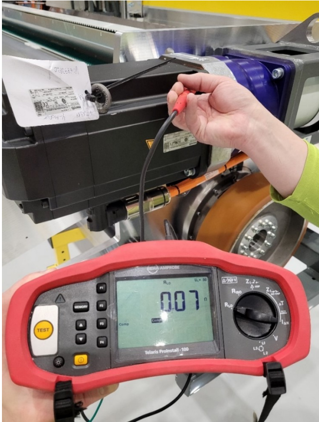
Kuva 6. Suojajohtimen jatkuvuuden mittaaminen. (Lehtovirta 2022.)
