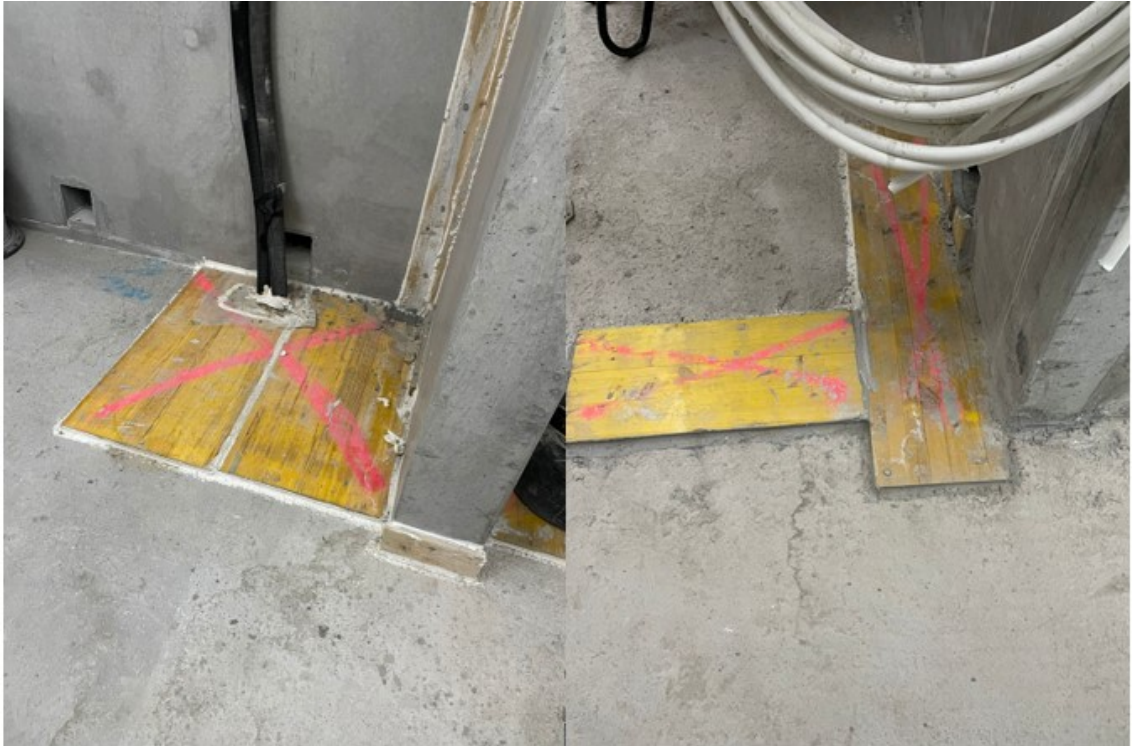
Kuva 11. Läpivienti aukot toimivat yhtäaikaaisesti kerroksen vesikatkona ja putoamissuojana.
