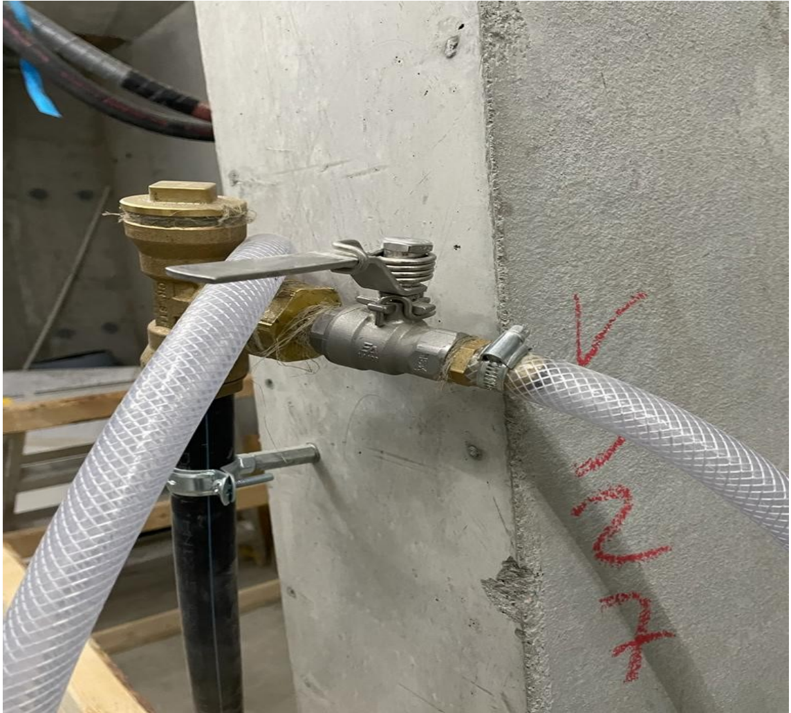
Kuva 18. Jokaisen kerroksen vesipisteessä on palloventtiilihana jousipalautuksella.
