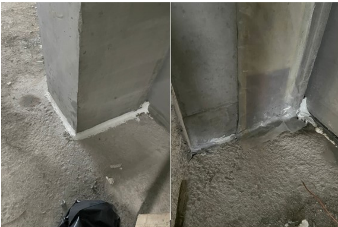
Kuva 16. Hormi kulkee jokaisessa kerroksessa samaa linjaa pitkin. Saumakohtat on kitattu umpeen, jotta hormi olisi vesitiivis.
