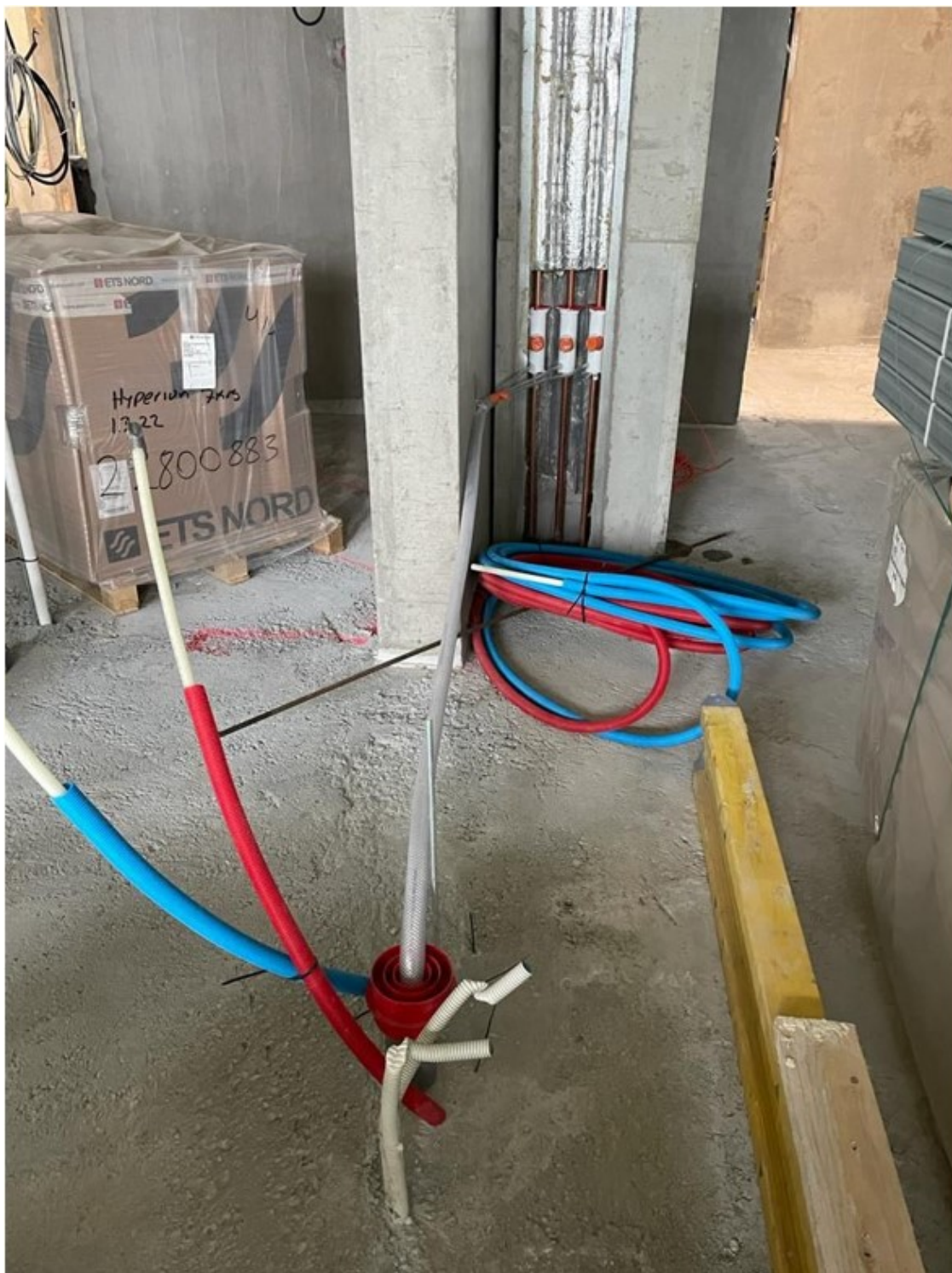
Kuva 17. Jokaisen kerroksen pystyjakojohtoihin asennetaan vuodonilmaisimet.
