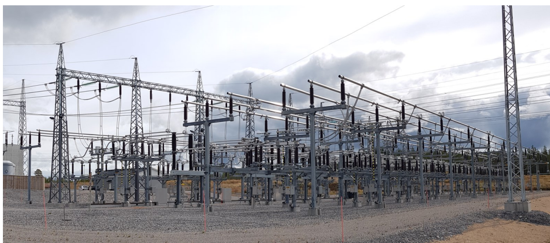
Kuva 3. Jylkkä 110 kV avorakenteinen ulkokytkinlaitos. Fingrid [15]
