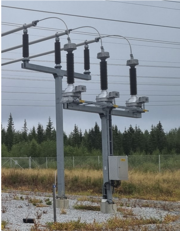
Kuva 8. Kiskojännitemuuntajia Uusnivalan 110 kV kytkinlaitoksella. Fingrid [30]
