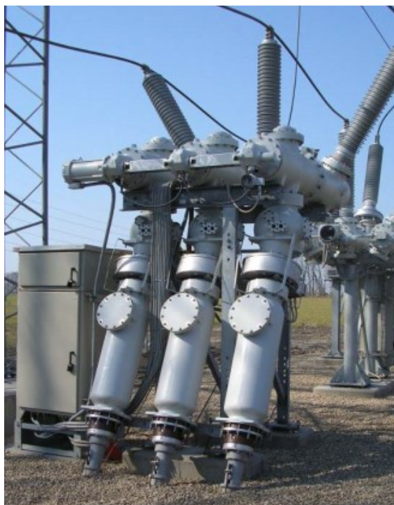
Kuva 13. Kaapelipäättein varustettu PASS hybridikojeistomoduli. ABB [41]
