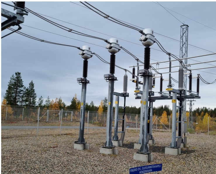
Kuva 7. Virtamuuntajia Vajukosken 110 kV kytkinlaitoksella. Fingrid [28]
