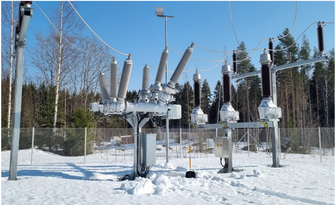
Kuva 17. Humalamäki 110 kV sähköasema. Savon Voima Verkko Oy [51]
