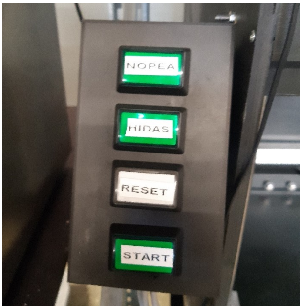
Kuva 43. Käyttöliittymä asennettuna paikoilleen.
