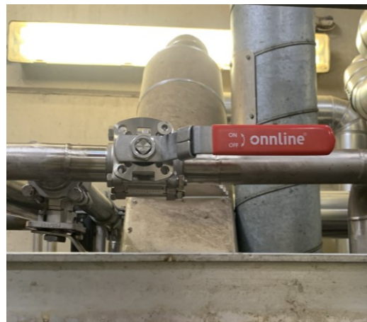
KUVA 17. Ohituslinjan venttiili V-204
