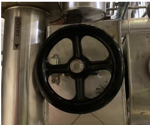
KUVA 20. Säiliön B-205 höyryventtiili V-500
