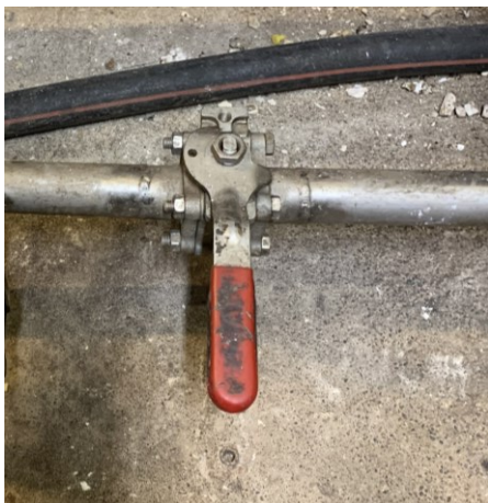
KUVA 16. Suodattimen venttiili V-203
