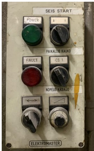
KUVA 18. Pumpun P-200 ohjauspaneeli
