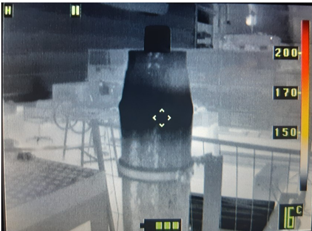
Kuva 16 Cryogel® Z kappaleessa oli tehty eristyksen asennusvaiheessa liitosvirhe, jossa eriste kerrokset olivat asennettu päittäin kun kerrokset olisi pitänyt asentaa limittäin lämpövuodon minimoimiseksi
