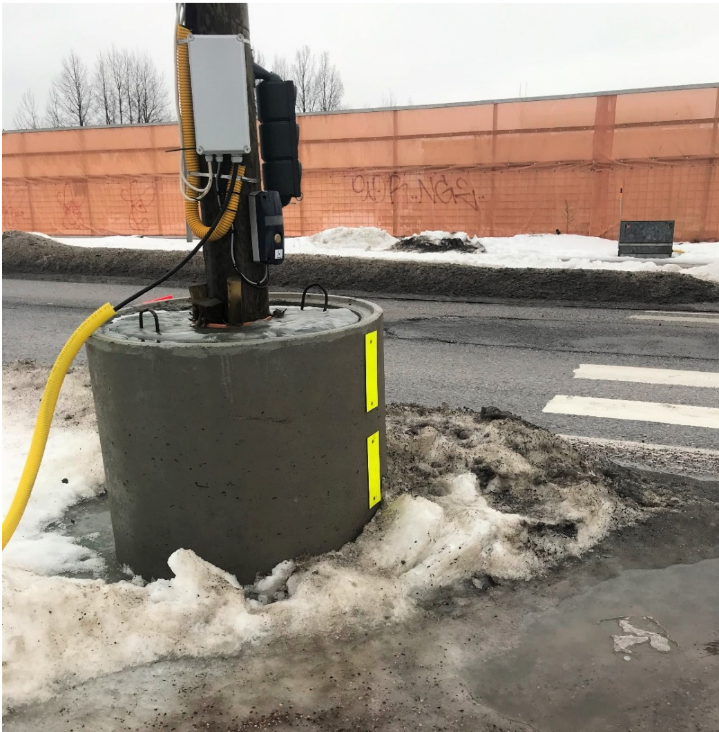
Kuva 18. Suojatien painonapin sijoitus työnaikaisessa liikennevalopylväessä.
