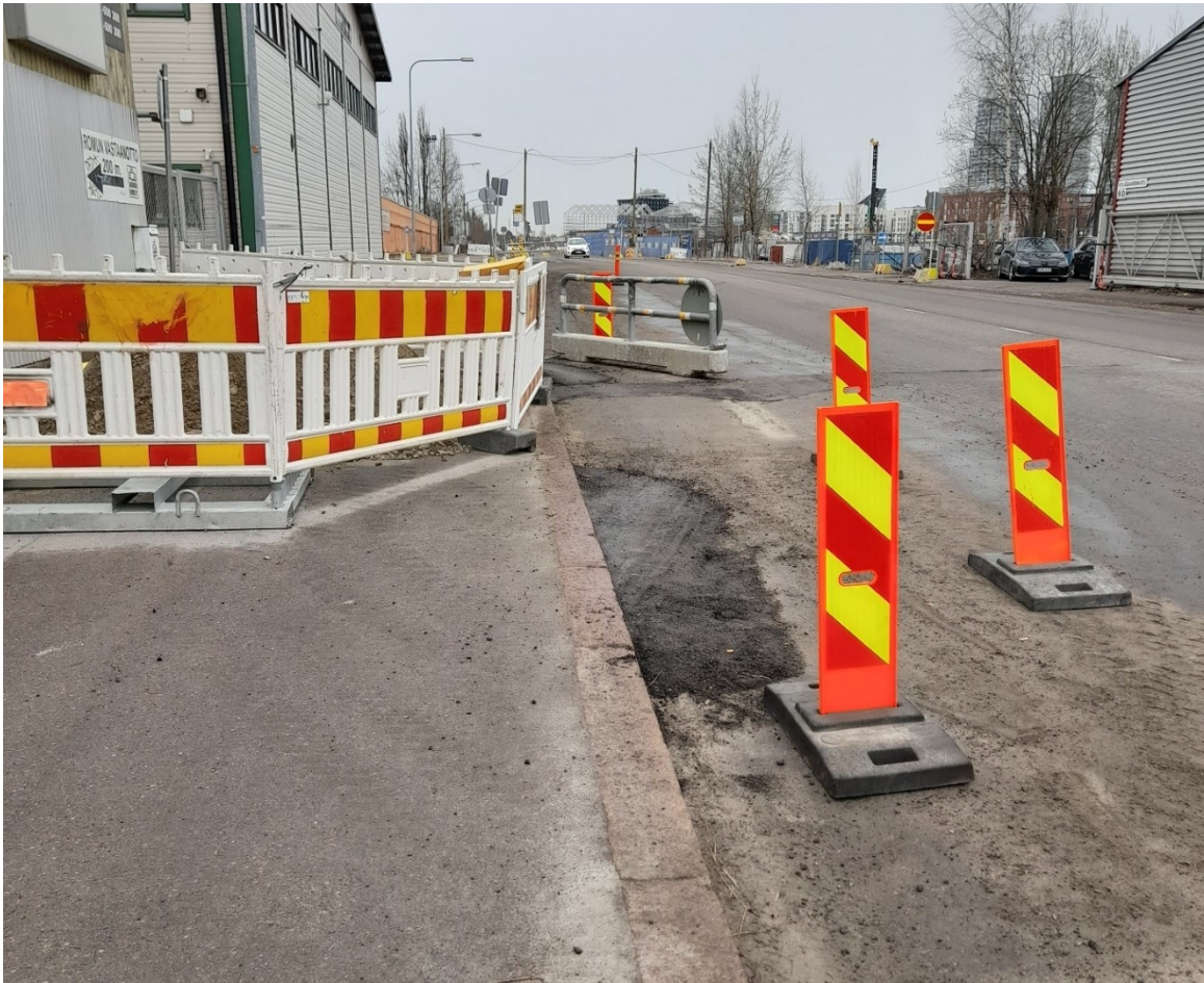
Kuva 14. Kylmämassalla luiskatut reunatuet ja puutteellinen kulkuväylän rajausta.
