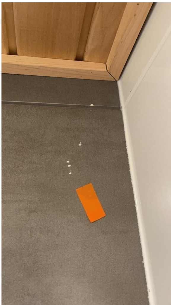
KUVA 7. Puutteellinen suojaus laatoituksen jälkeen (Räsänen 2021)
