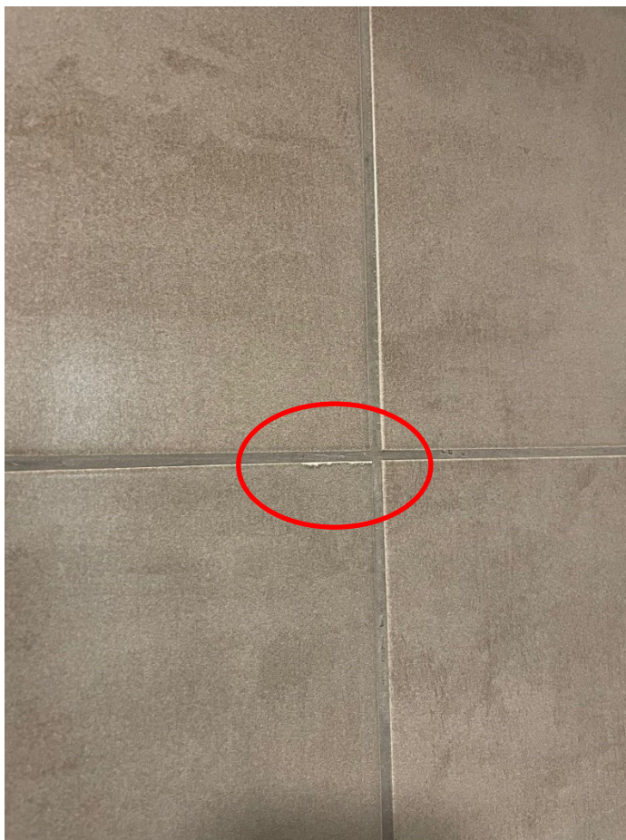
KUVA 2. Materiaalivirhe laatassa, jota ei ole huomioitu ennen laatoittamista (Räsänen 2021)
