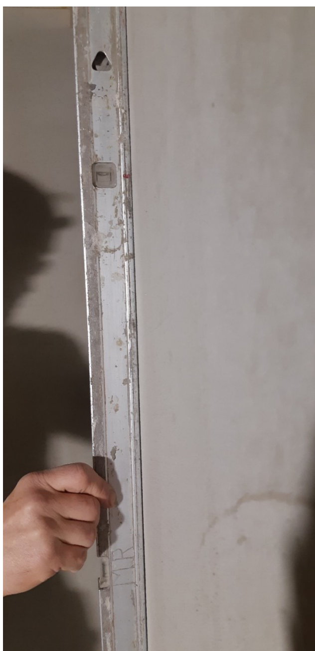
KUVA 6. Varmistetaan ettei seinässä ole kohoumia ennen vedeneristyksen laittamista ja laatoitusten asentamista (Räsänen 2021)
