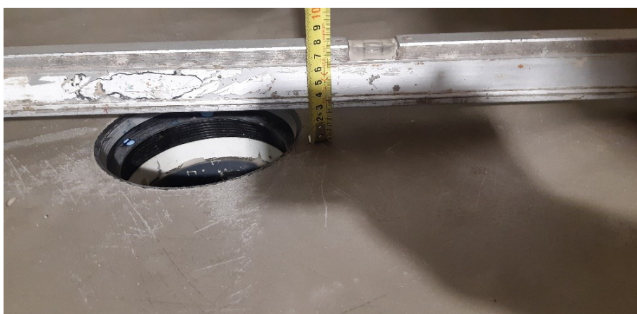
KUVA 4. Kallistus lattiakaivon vieressä (Räsänen 2021)
