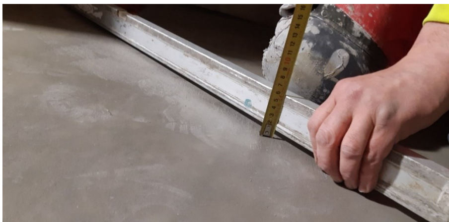
KUVA 5. Kallistus kylpyhuoneen lattiassa (Räsänen 2021)
