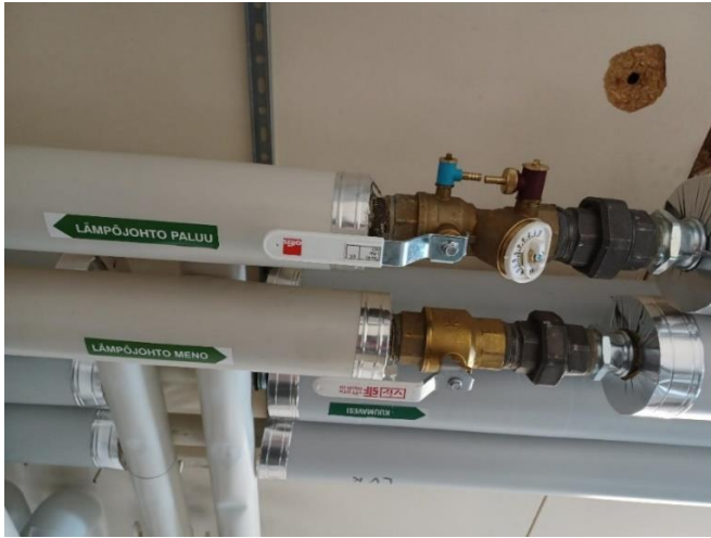
Kuva 21. Lämmönjakuhuoneessa sijaitsevat linjasäätöventtiilit.
